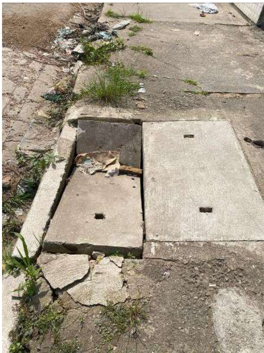
Foto 91: Vista da caixa de passagem do sistema de drenagem de águas pluviais. Nota-se a condição precária do local que apresenta além de danos estruturais, sujeidade generalizada com o crescimento de vegetação dado o acúmulo de água.
