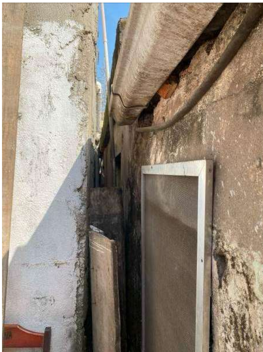
Fotos 90: Vista da divisão entre o imóvel do Réu e do outro vizinho (Rua Própria), geminado com o imóvel da Autora.
