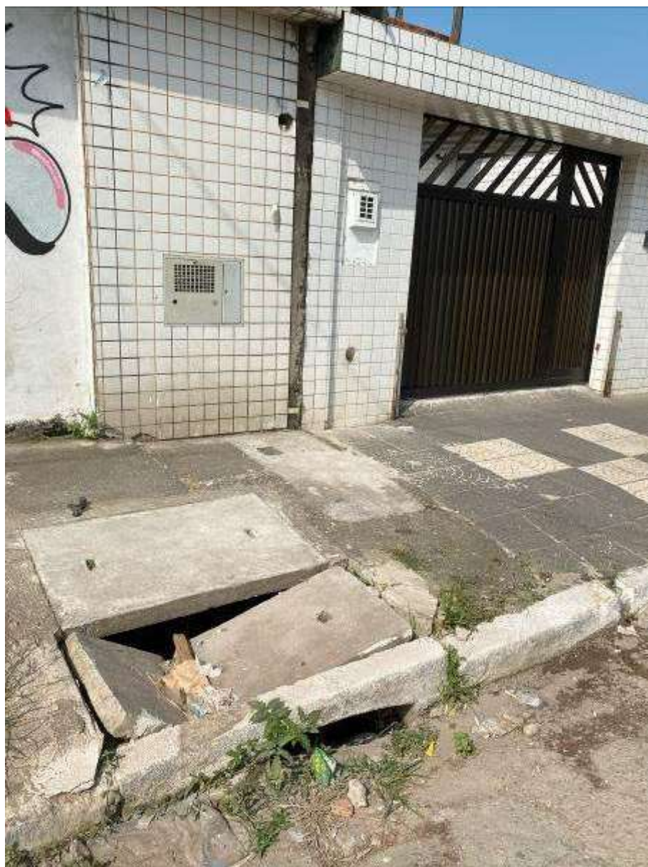
Foto 92: Idem foto anterior, por outro ângulo. Nota-se que o sistema de drenagem está localizado na calçada bem próximo da divisa entre os imóveis objeto da presente lide.
