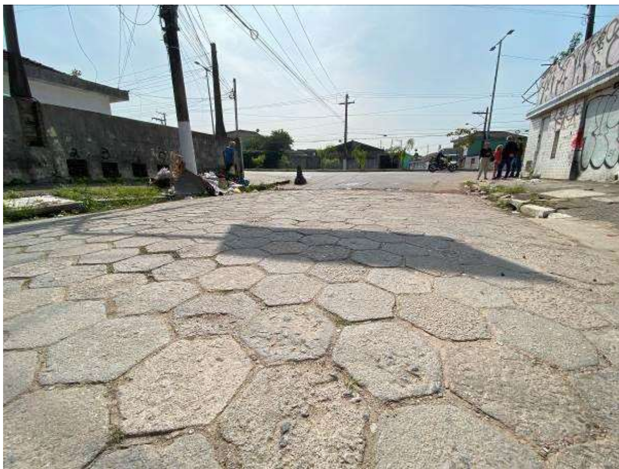
Foto 95: Vista parcial do leito carroçável da região. Pode-se observar perfeitamente o caimento expressivo existente, no sentido Avenida Dr. Haroldo de Camargo para Rua Própria.
