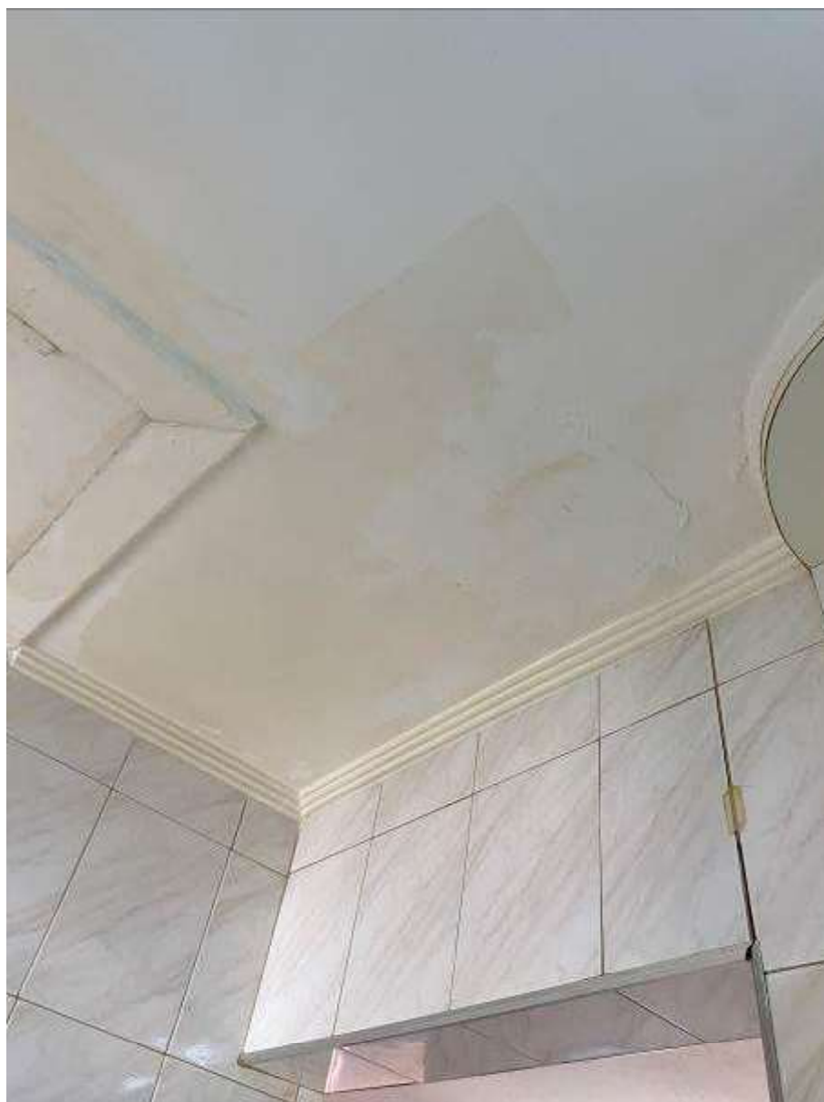
Foto 63: Nova vista parcial do teto da Despensa. Em destaque, o deslocamento da estrutura e a existência de fissura no teto.
