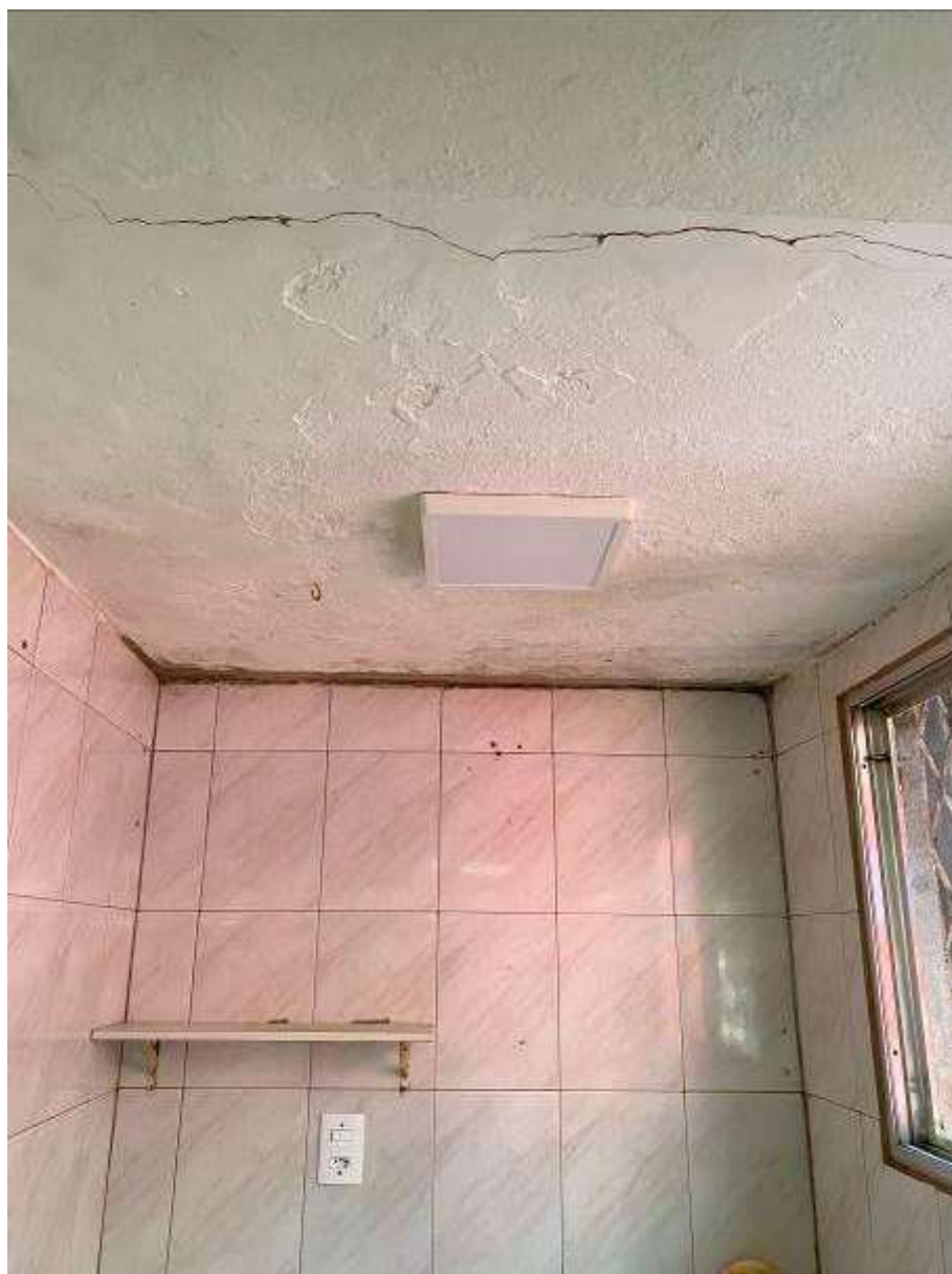
Foto 66: Vista geral do teto da área de serviço. Nota-se a existência de manchas de umidade e trinca no local.
