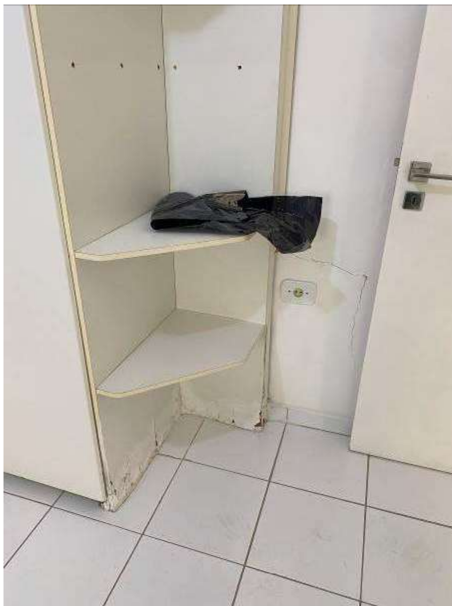
Foto 49: Vista parcial do armário embutido do Dormitório 1. Nota-se os danos na base do mobiliário devido ao contato com a água. Também é possível observar a existência de rachadura provavelmente passante para o Dormitório 2.
