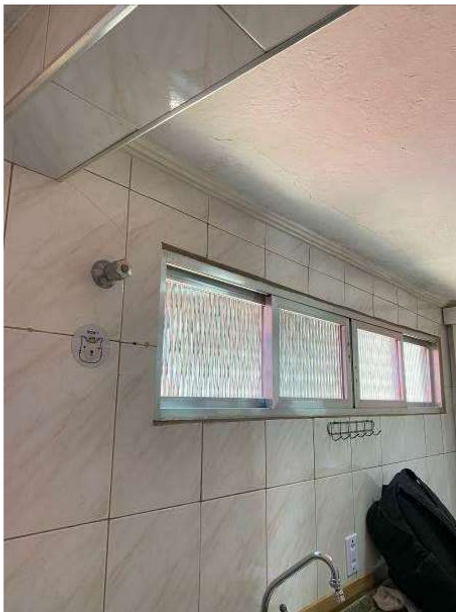
Foto 71: Vista geral do teto da Cozinha. Nota-se a existência de fissura e trinca no revestimento cerâmico.
