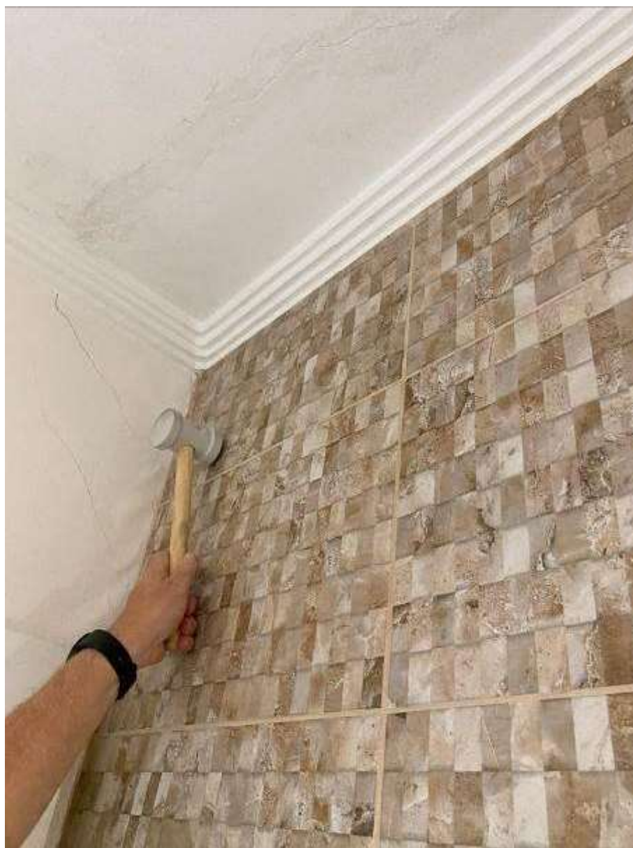
Foto 54: Vista de outra parede do Dormitório 2. O Perito atestou a emissão de som cavo nesta área.
