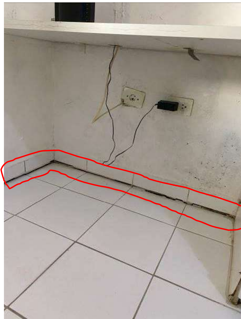
Foto 40: Vista, em detalhe, de uma das paredes do Dormitório 1. Nota-se a existência de manchas de umidade e o deslocamento da estrutura. O Perito atestou a emissão de som cavo nesta área do piso.
