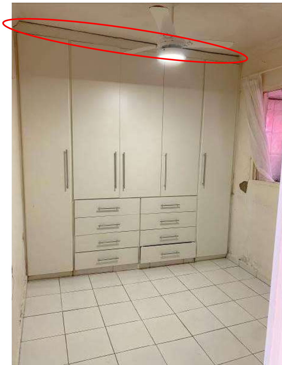
Foto 53: Vista geral do Dormitório 2. Em destaque, o deslocamento do armário embutido.
