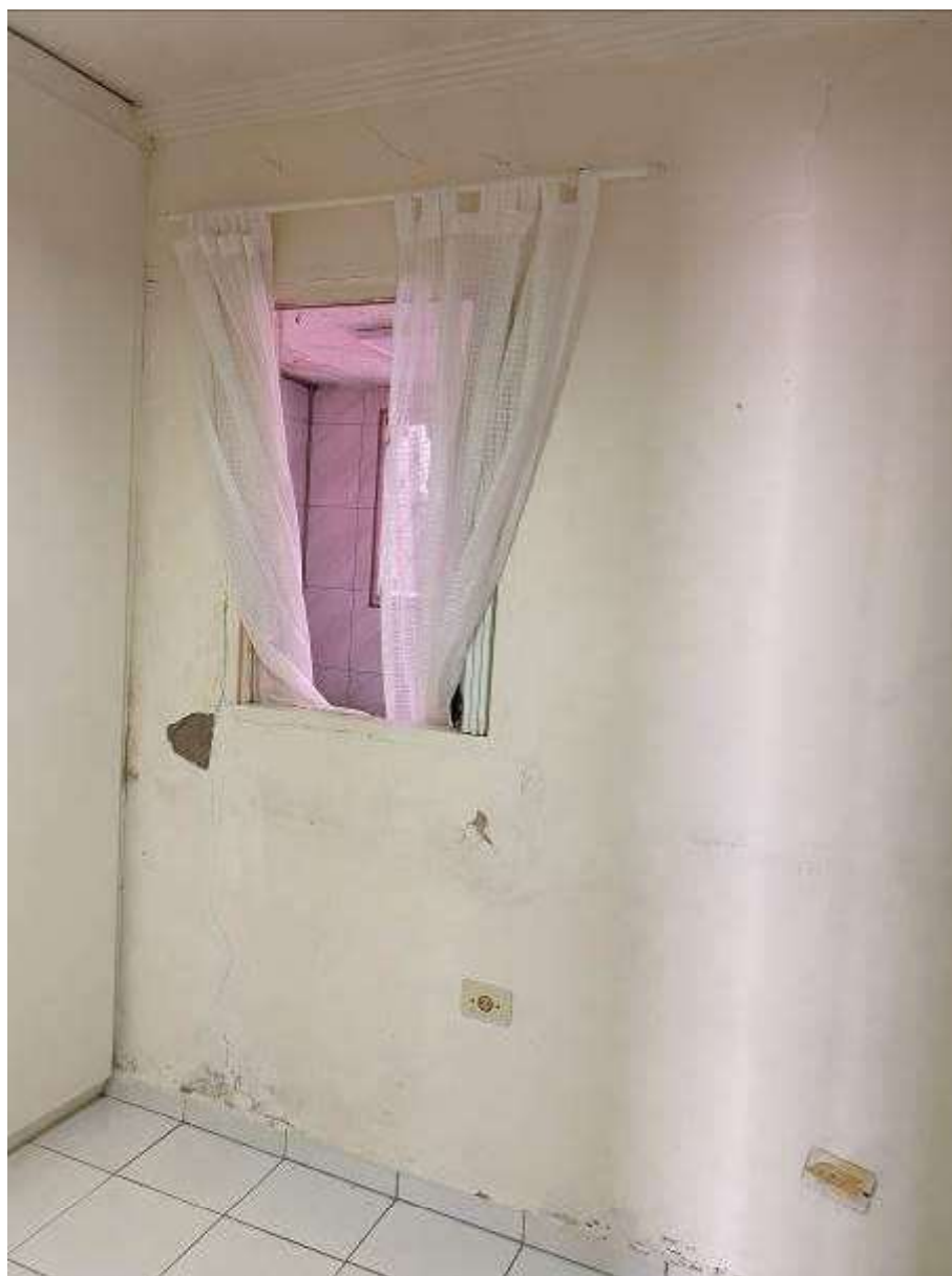
Foto 55: Vista de uma das paredes do Dormitório 2. Em destaque, a existência de manchas de umidade e deslocamento de pintura, bem como fissuras generalizadas.
