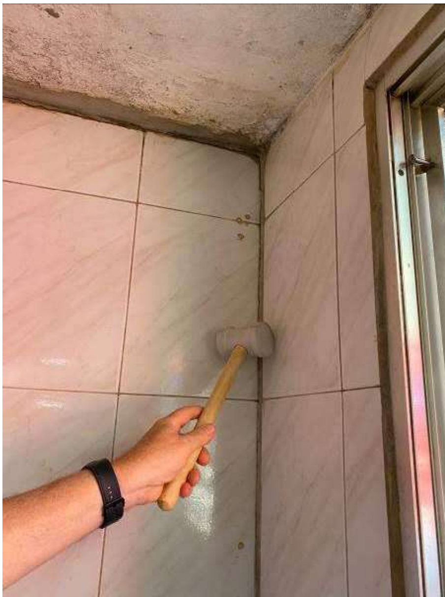
Foto 69: Vista de paredes da Área de Serviço. O Perito atestou a emissão de som cavo nesta área.
