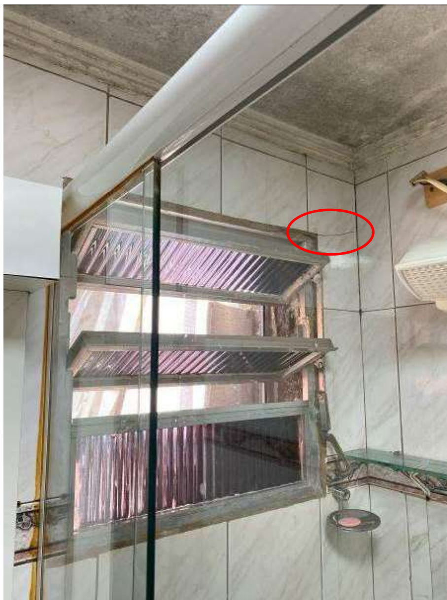
Foto 77: Nova vista parcial do Banheiro. Em destaque, trinca no revestimento cerâmico, sem nexo de causalidade com a lide, posto tratar-se de falta de manutenção da cobertura adicional da Autora.
