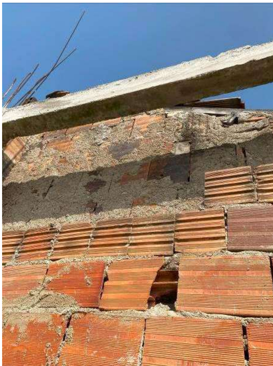
Foto 85: Vista, em detalhe, da estrutura remanescente à demolição, ou seja, o imóvel da Autora e o muro divisório existente. Nota-se a total falta de acabamento no local.
