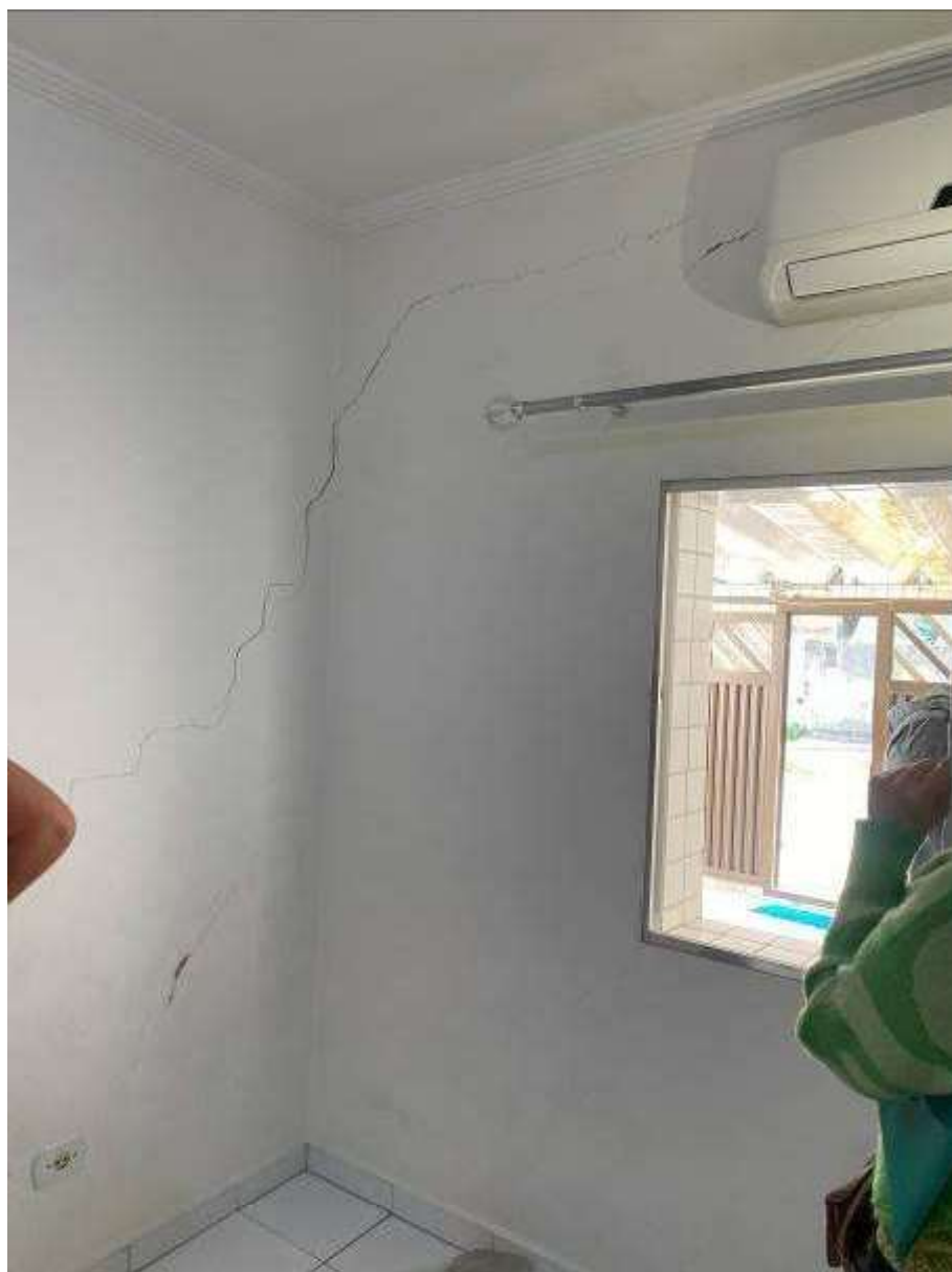
Foto 44: Outra vista de parede do Dormitório 1. Em destaque, a rachadura passante do Dormitório 1 para a Sala.
