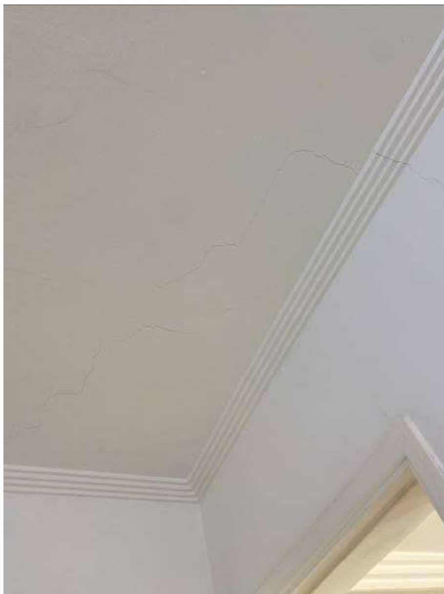
Foto 52: Vista parcial do teto do Dormitório 1. Nota-se a existência de fissuras no local.
