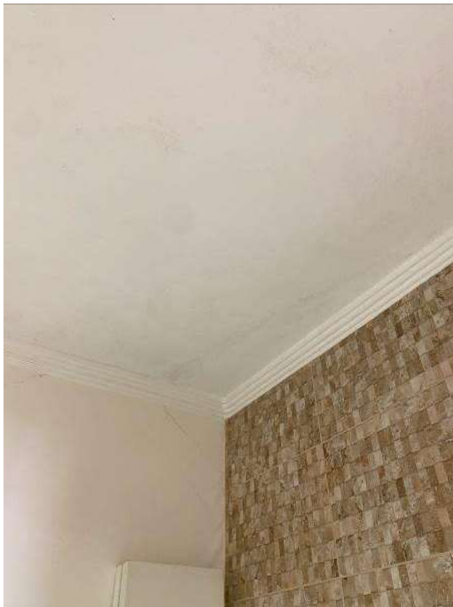
Foto 57: Outra vista parcial do teto do Dormitório 2, com nova fissura existente.
