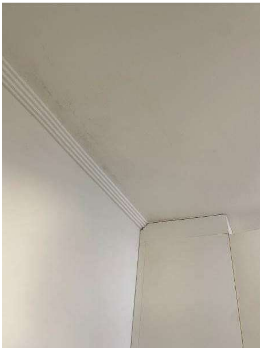
Foto 43: Vista parcial do armário embutido do Dormitório 1. Nota-se o deslocamento parcial do mobiliário.
