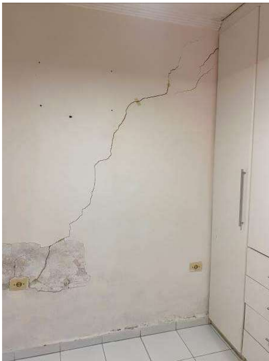
Foto 58: Vista de outra parede do Dormitório 2. Em destaque, a existência de rachadura provavelmente passante para o Dormitório 1. Também é possível observar manchas de umidade e deslocamento da pintura.
