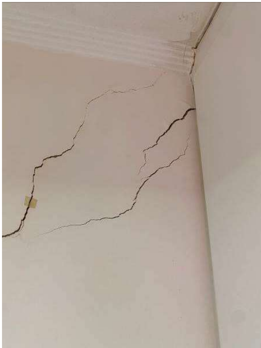
Foto 60: Vista, em detalhe, das rachaduras existente no Dormitório 2.
