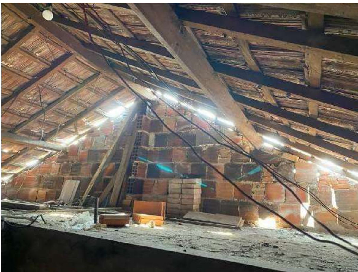
Foto 79: Vista geral do telhado e do fechamento lateral com o imóvel do Réu. Nota-se a existência de falhas no acabamento, com diversos pontos de abertura.
