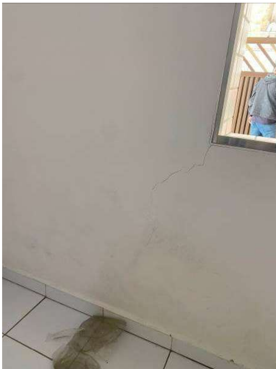
Foto 48 Vista de parede da janela do Dormitório 1. Nota-se a existência de trinca e manchas de umidade no local.
