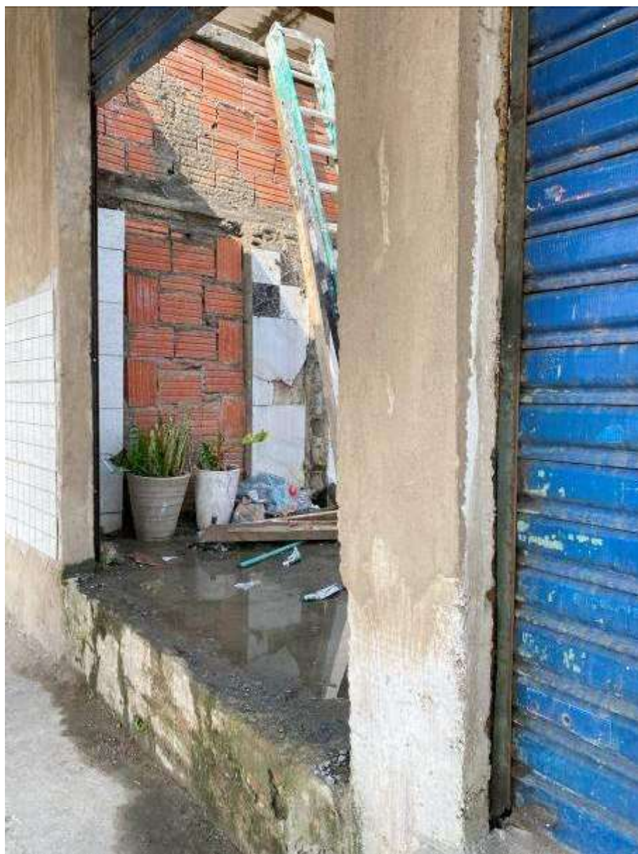
Foto 81: Vista do aceso à parte do imóvel do Réu. Nota-se a elevação do piso, tratando-se de área com alagamento.
