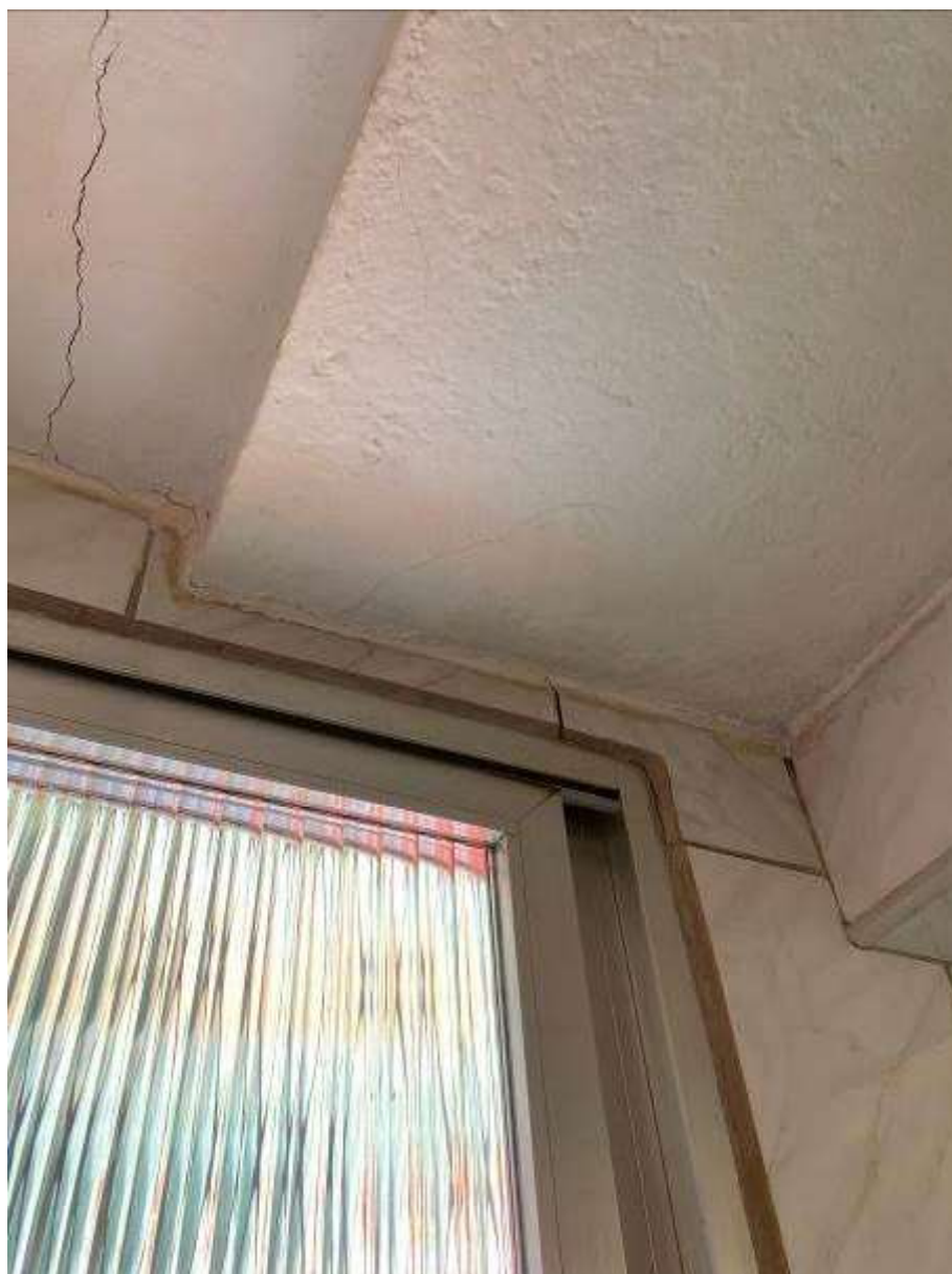
Foto 68: Outra vista parcial do teto da Área de Serviço. Nota-se a existência de trinca e fissuras no local.
