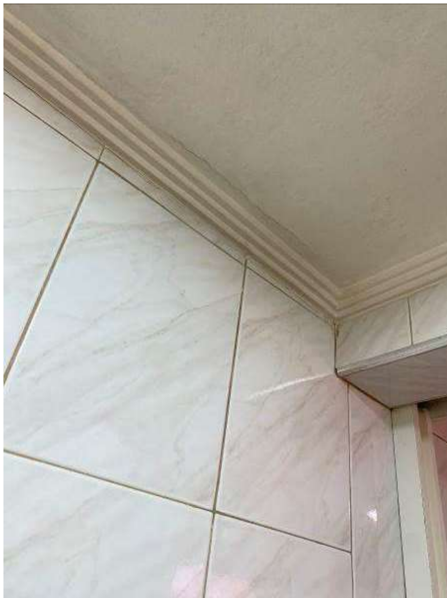
Foto 76: Outra vista do teto do Banheiro. Nota-se a existência de fissura.
