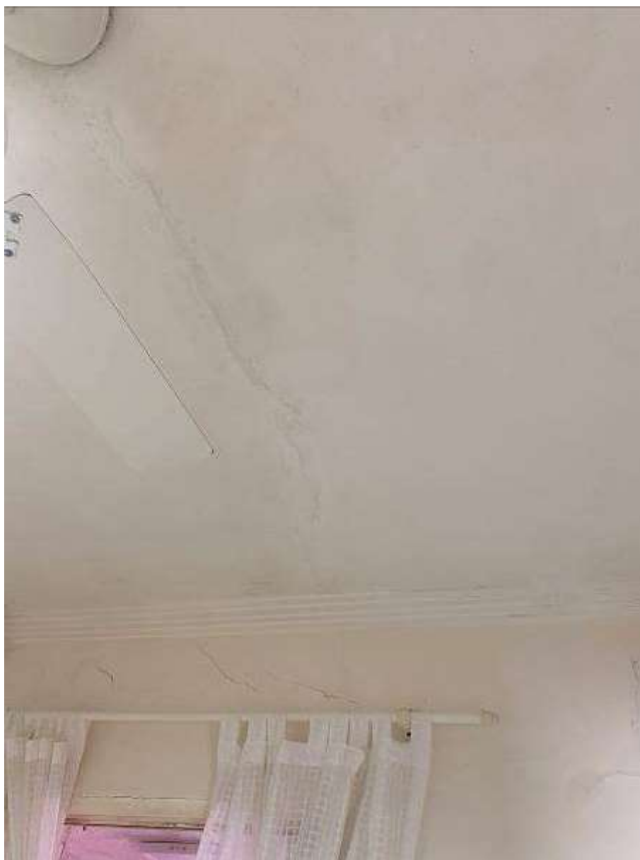
Foto 56: Vista parcial do teto do Dormitório 2. Nota-se a existência de fissura no teto.
