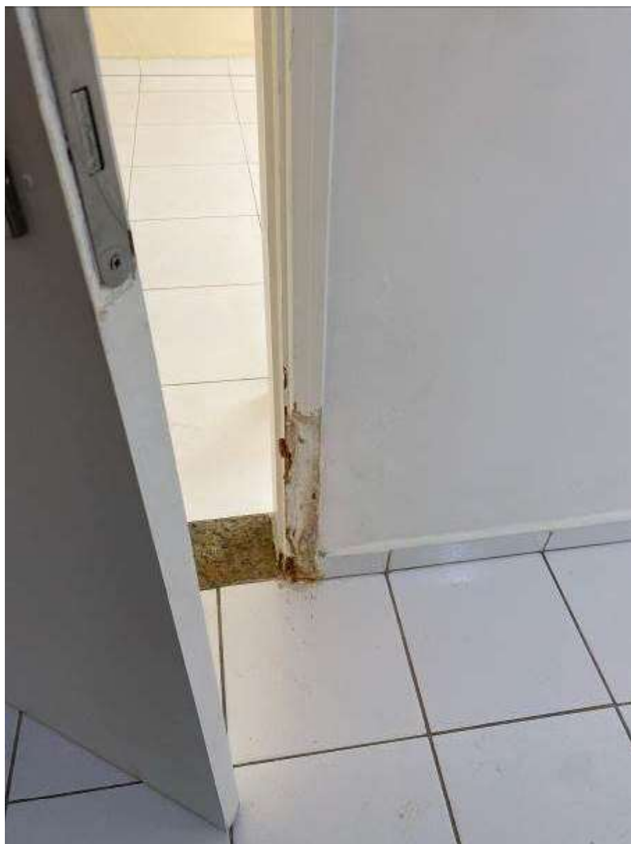
Foto 51: Vista parcial do batente da porta do Dormitório 1. Nota-se os danos devido ao contato com a água.
