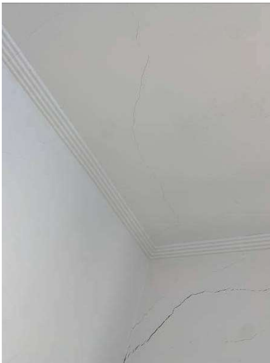
Foto 47: Vista parcial de parede e teto do Dormitório 1. Nota-se a existência de fissura no teto e parte da rachadura citada anteriormente.
