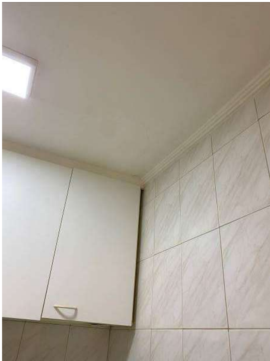
Foto 62: Vista parcial do teto da Despensa. Nota-se a existência de fissura no local.
