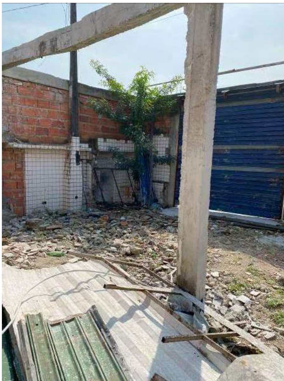
Foto 86: Vista parcial do terreno do Réu. Nota-se a execução de pilares e vigas em total desacordo com as normas vigentes e a boa técnica de engenharia.
