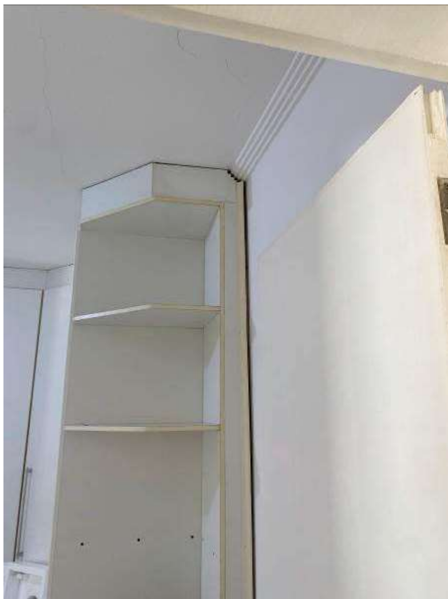
Foto 50: Outra vista do armário embutido do Dormitório 1. Nota-se o deslocamento do mobiliário. Também é possível observar a existência de fissuras no teto.
