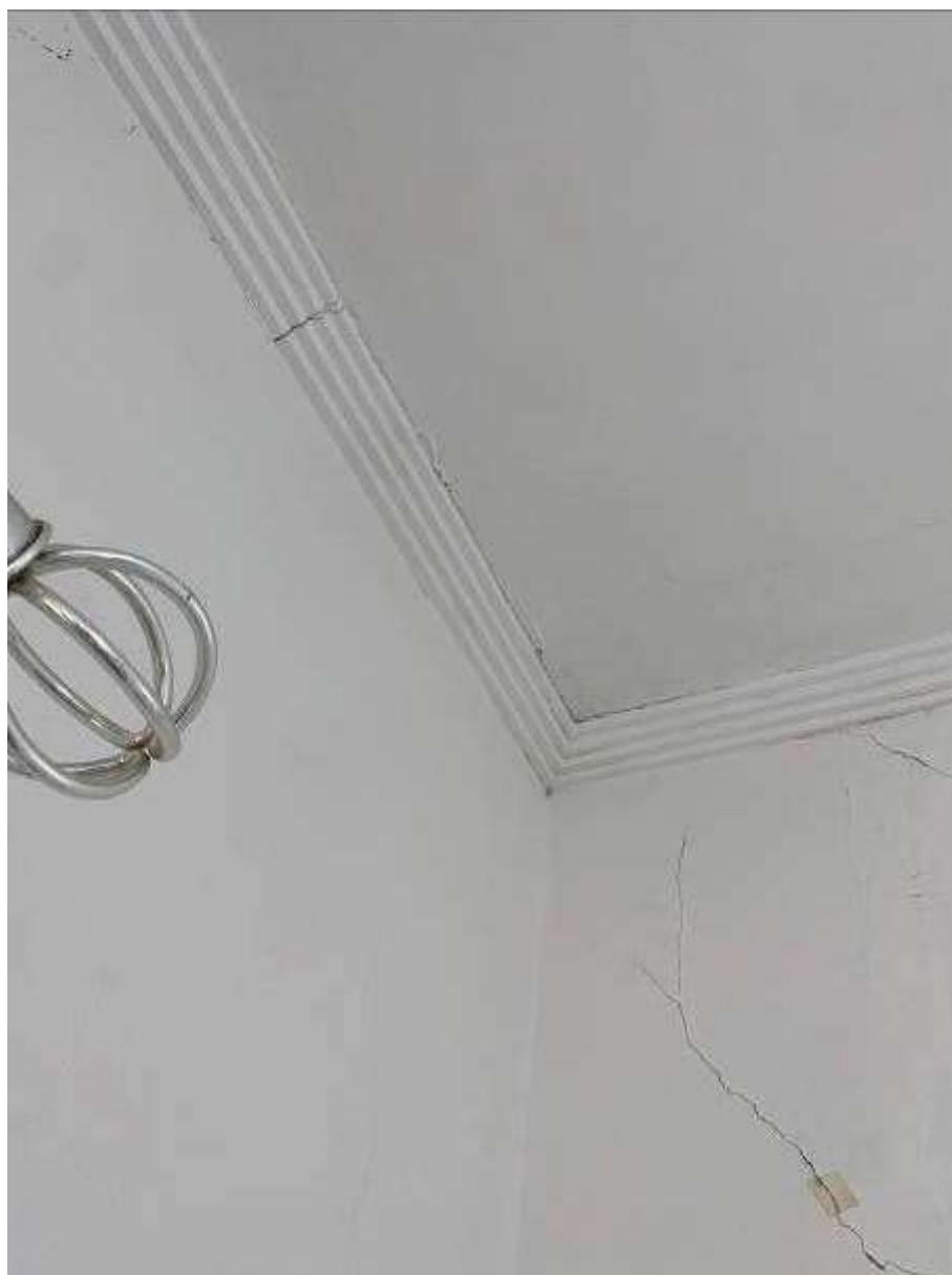
Foto 41: Vista parcial da parede e teto do Dormitório 1. Em destaque, a existência de fissuras e trincas nas paredes e moldura de gesso.
