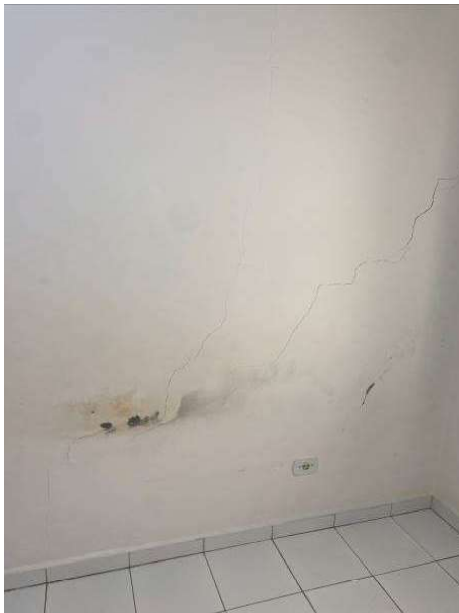
Foto 46: Outra vista da parede do Dormitório 1. Em destaque, a existência de manchas de umidade no local.
