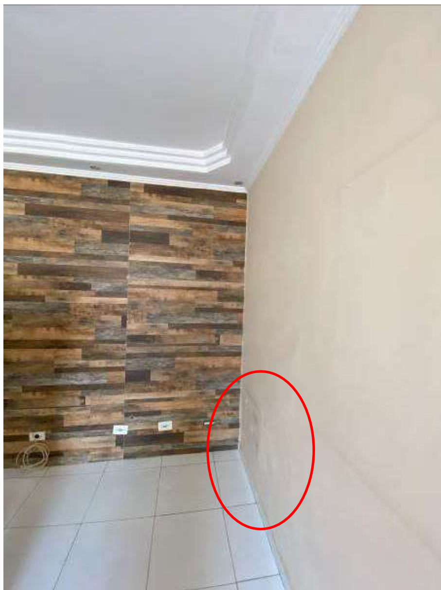
Foto 21: Vista parcial da Sala. Nota-se a existência de manchas de umidade e deslocamento da pintura.
