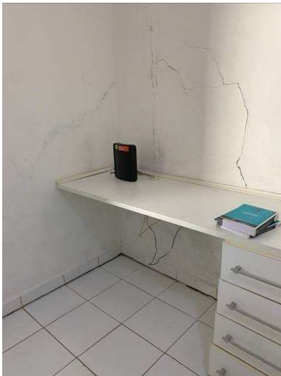
Foto 38: Vista de uma das paredes do Dormitório 1. Nota-se a existência de fissuras e trincas. Também é possível observar manchas de umidade nas paredes.
