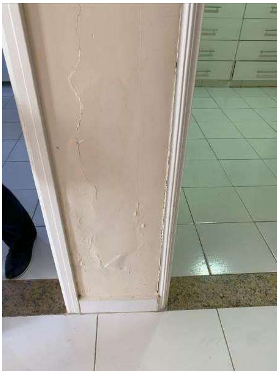
Foto 36: Vista de parede da Sala, entre os dormitórios. Em destaque, a existência de fissura e deslocamento/empolamento da pintura.
