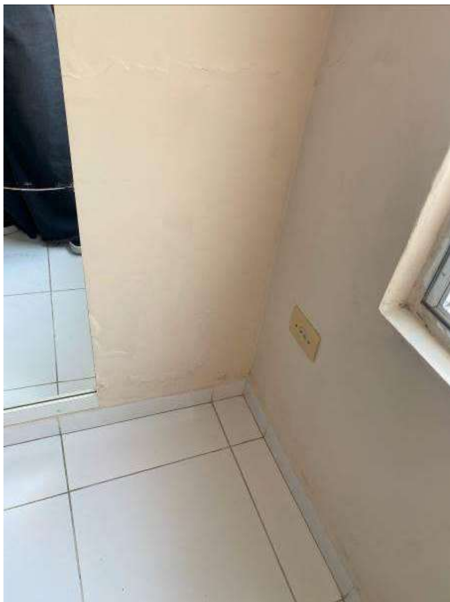
Foto 25: Outra vista da parede da Sala. Nota-se a existência de manchas de umidade e deslocamento/empolamento da pintura.
