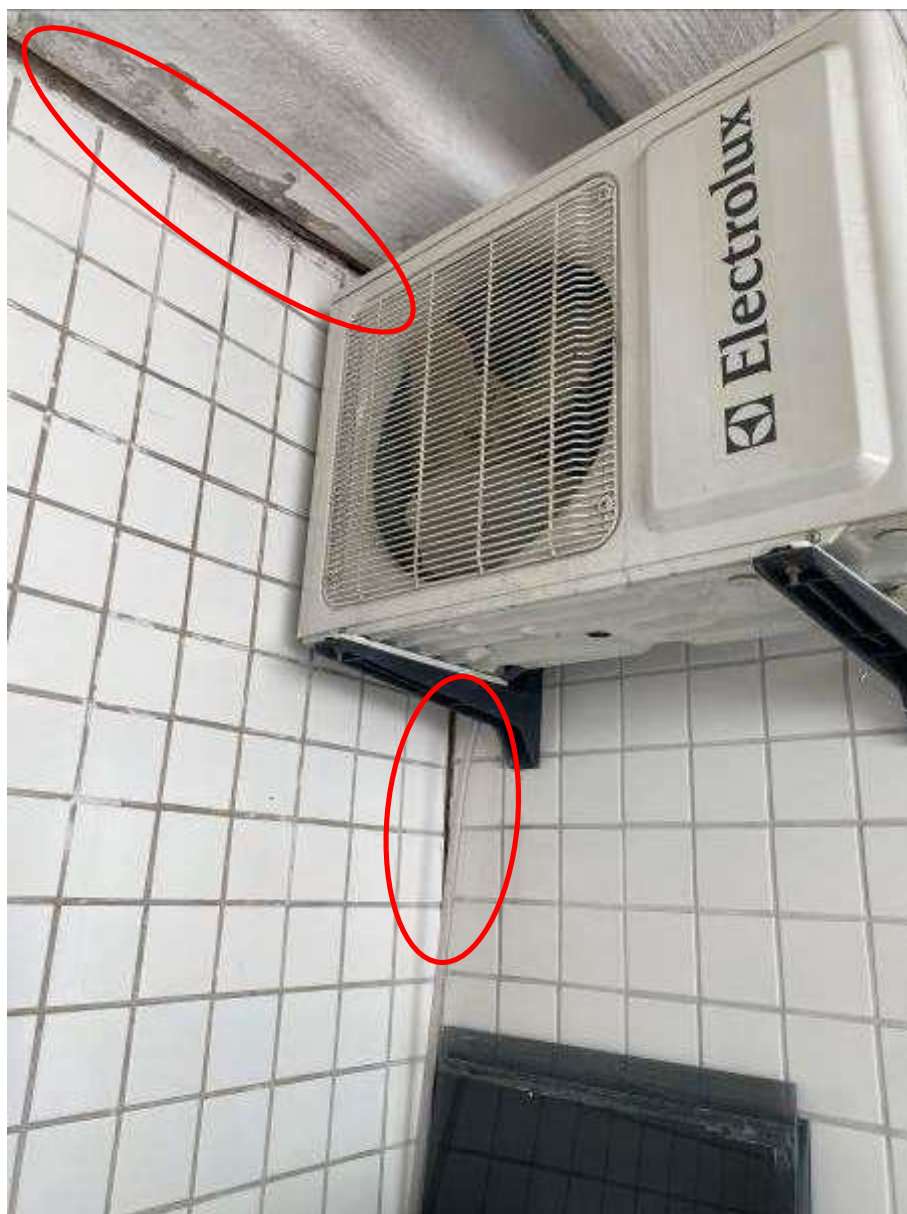
Foto 17: Vista da parede do imóvel da Autora junto ao imóvel do Réu. Nota-se o deslocamento da estrutura.
