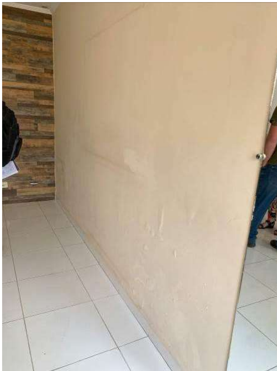
Foto 23: Vista de uma das paredes da Sala. Nota-se a existência de manchas de umidade e deslocamento/empolamento da pintura.
