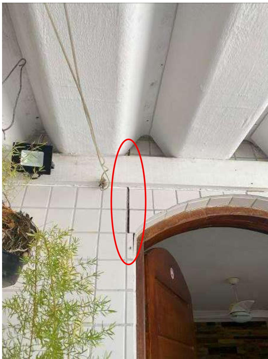
Foto 13: Vista da porta de acesso à Sala. Nota-se o deslocamento da estrutura.
