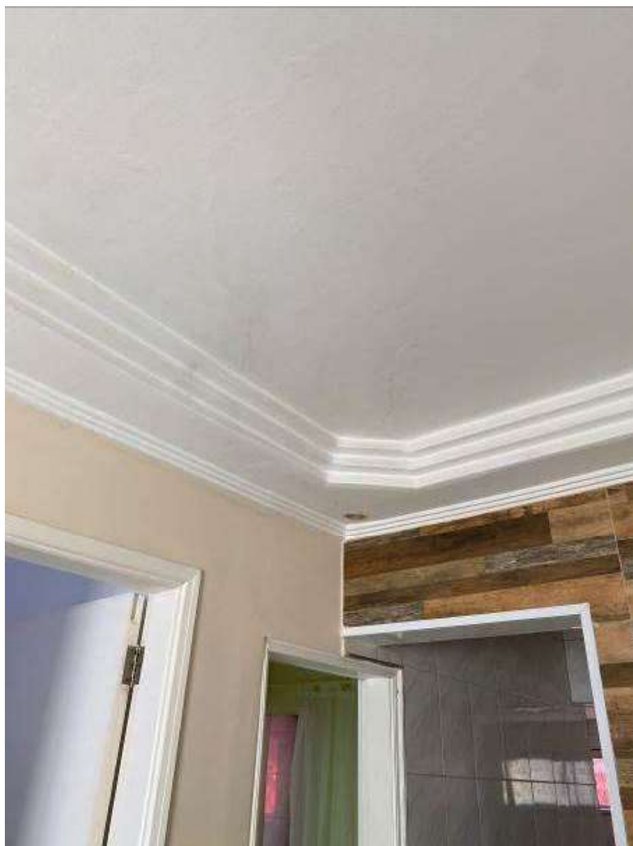
Foto 35: Outra vista do teto da Sala. Em destaque, a existência de fissuras no local.
