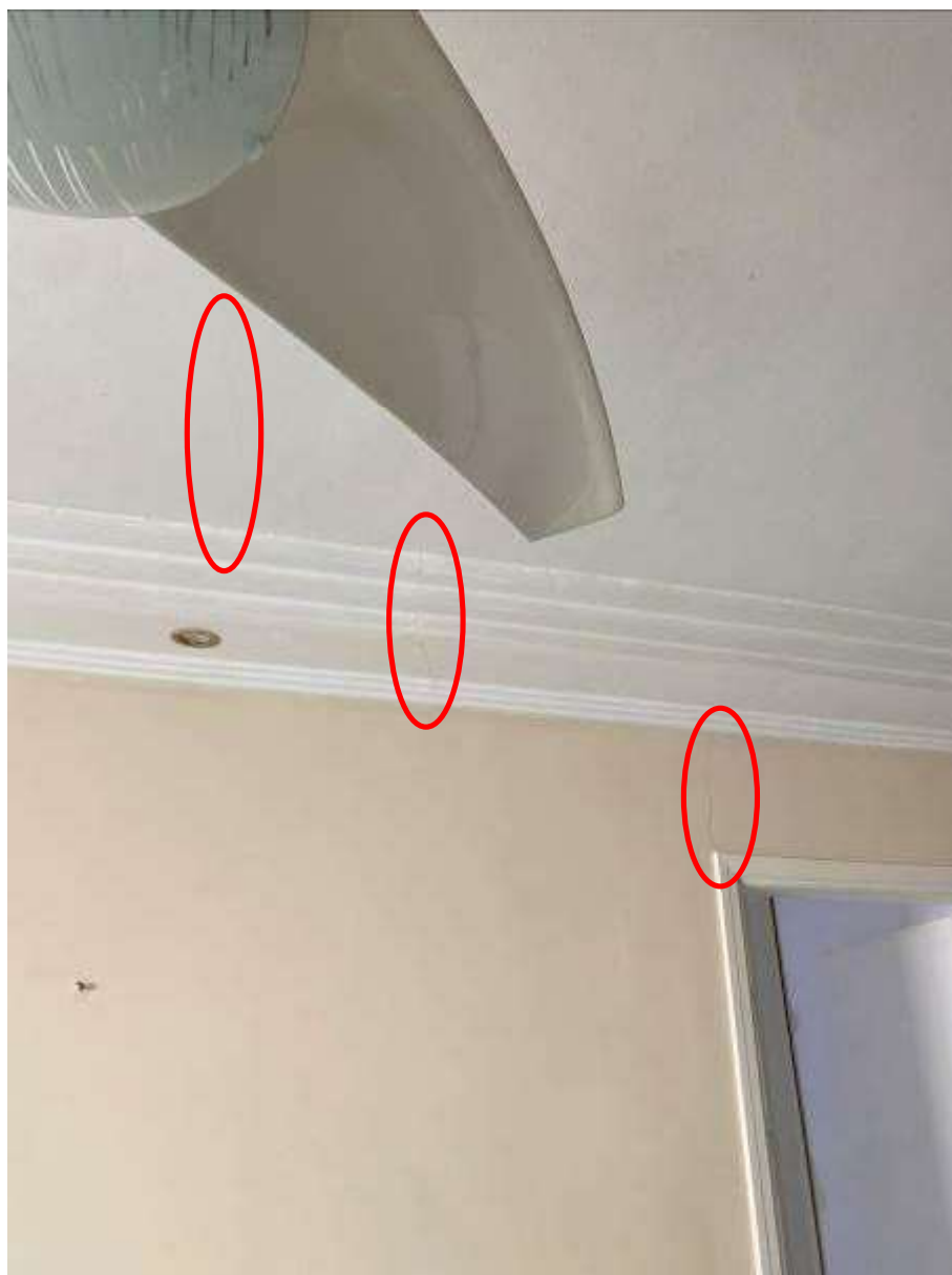
Foto 33: Idem foto anterior, por outro ângulo. Em destaque, a existência de fissuras na sanca de gesso, parede e teto.
