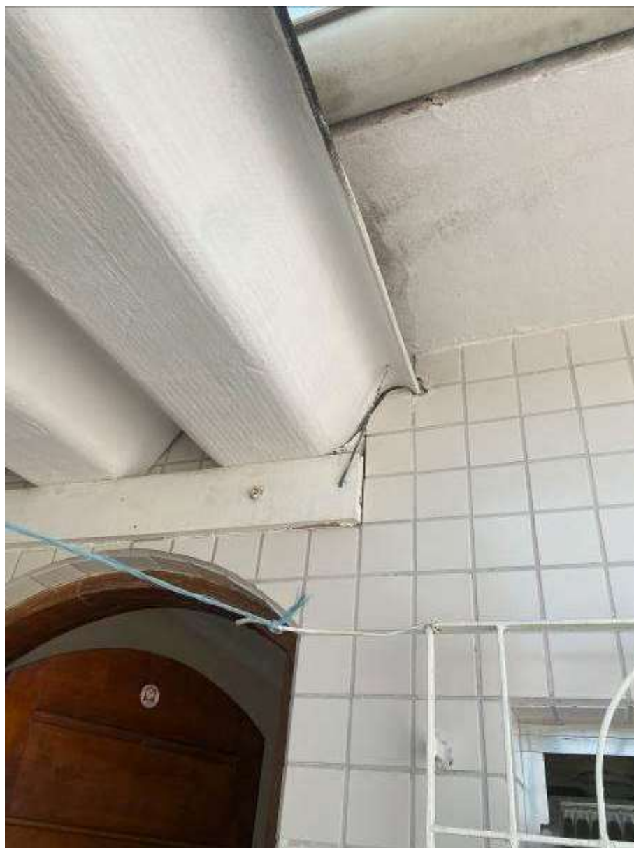
Foto 14: Idem foto anterior, por outro ângulo. Em destaque, o deslocamento da estrutura.
