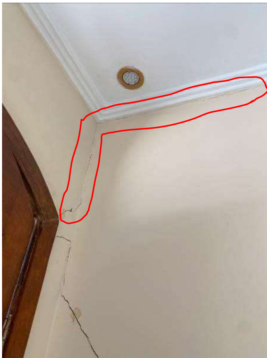
Foto 31: Idem foto anterior, por outro ângulo. Em destaque, a existência de fissura junto ao teto.
