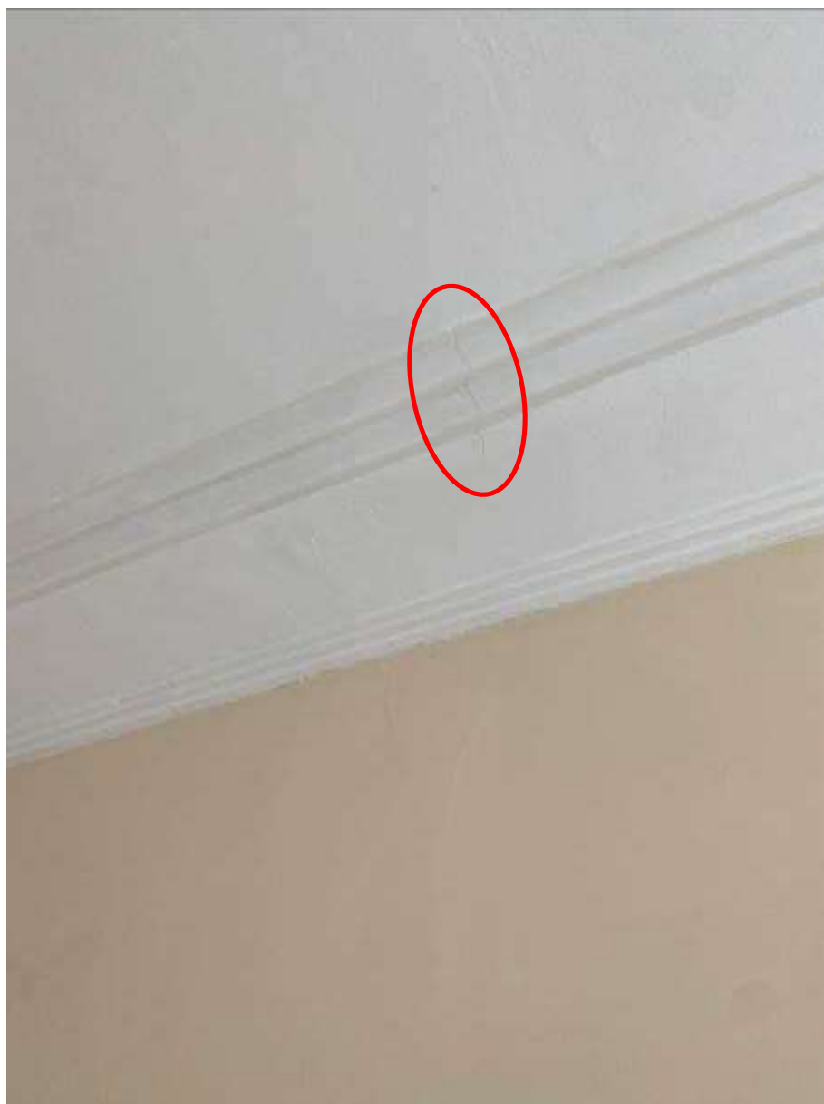
Foto 24: Vista parcial da sanca de gesso da Sala. Em destaque, a existência de fissura.
