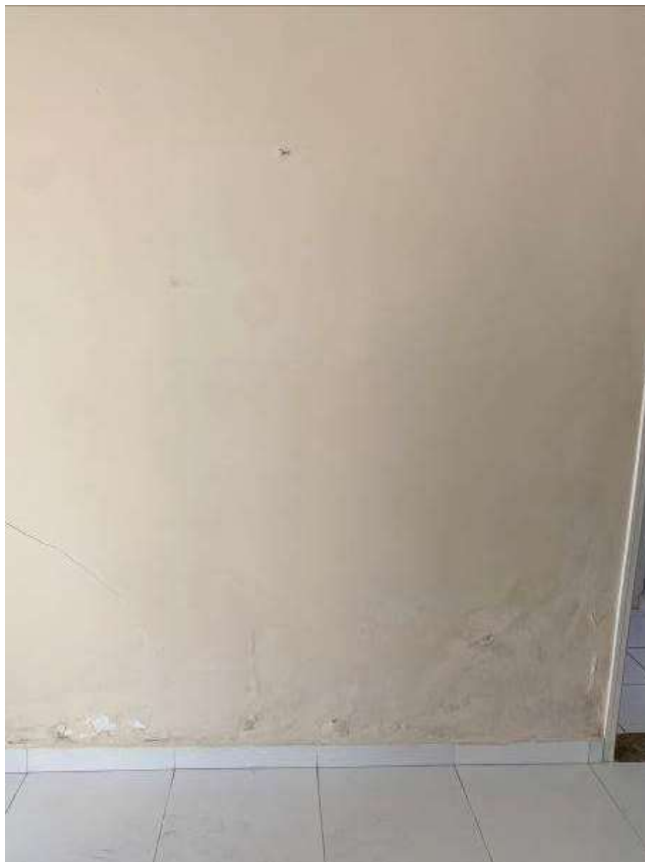
Foto 32: Vista, em detalhe, de parede da Sala. Nota-se a existência de manchas de umidade e deslocamento/empolamento da pintura.
