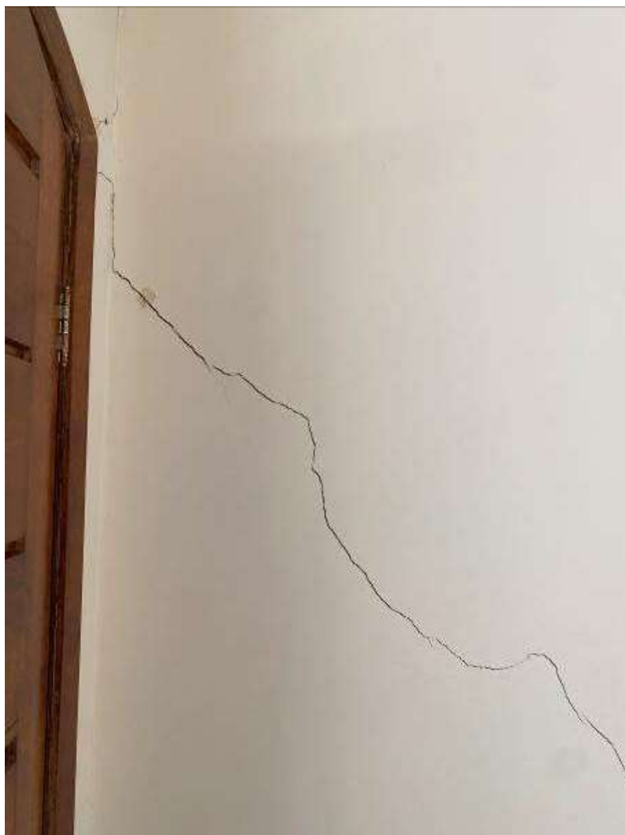
Foto 29: Vista, em detalhe, da rachadura passante da Sala para o Dormitório 1.
