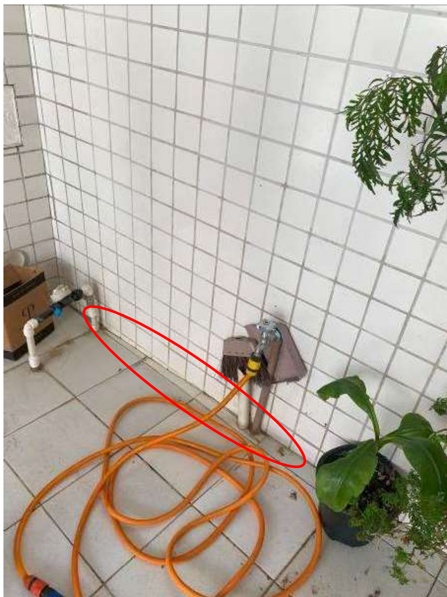
Foto 18: Vista da parede do imóvel da Autora junto ao imóvel do Réu. Nota-se a existência de trinca/descolamento da estrutura.
