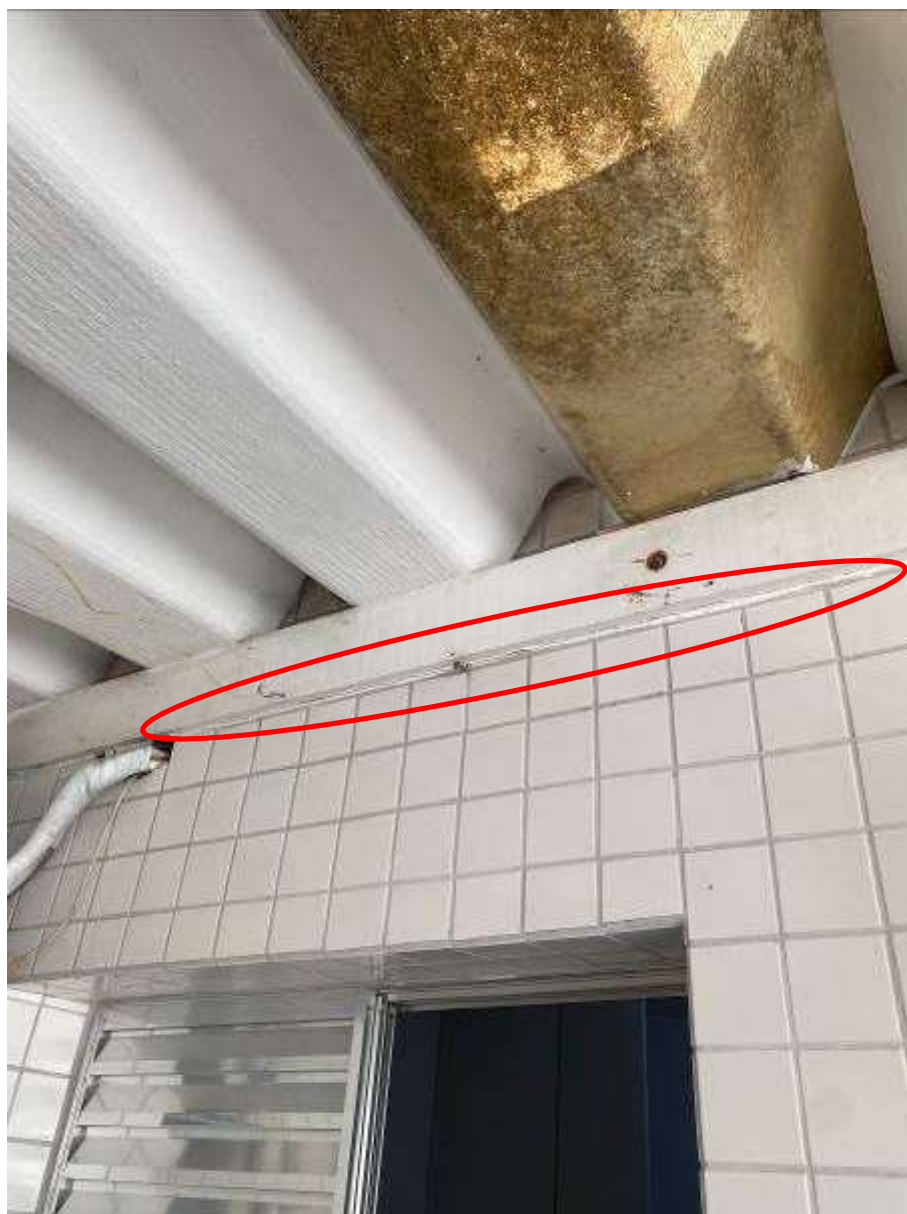
Foto 16: Vista da fachada do imóvel. Nota-se a existência de nova fissura junto ao vigamento de suporte da cobertura.
