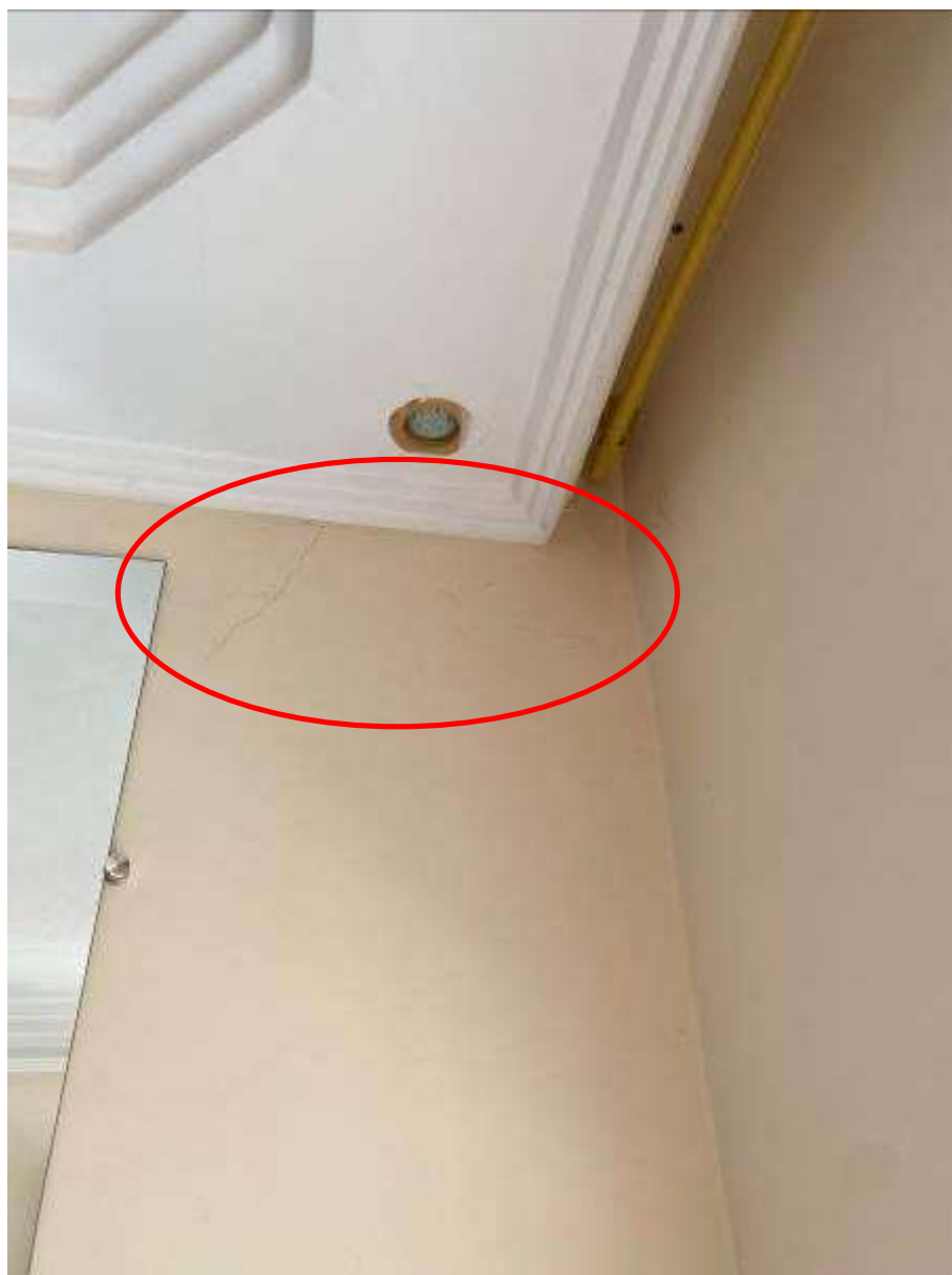
Foto 26: Idem foto anterior, por outro ângulo. Em destaque, a existência de fissuras no local.
