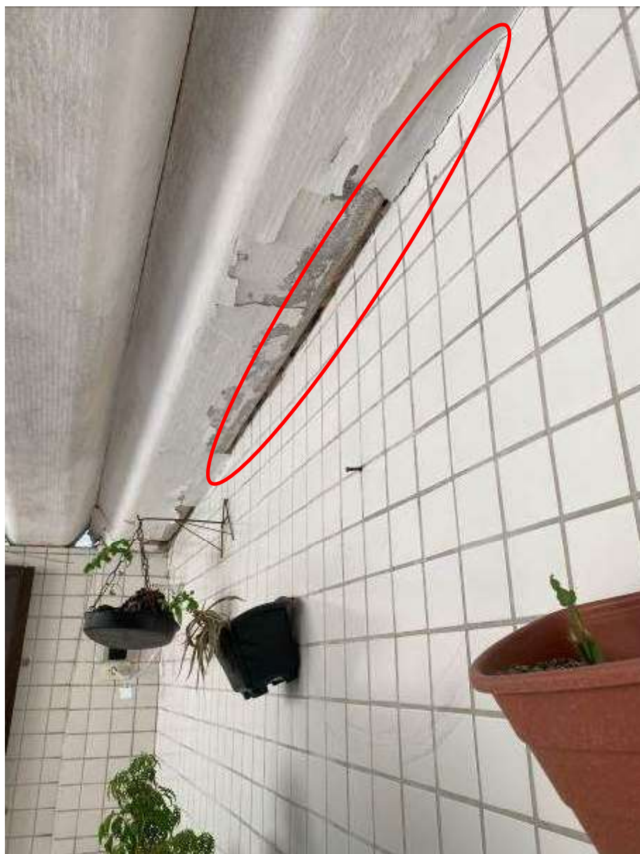
Foto 19: Idem foto anterior, por outro ângulo. Destaque para descolamento da estrutura junto a cobertura.
