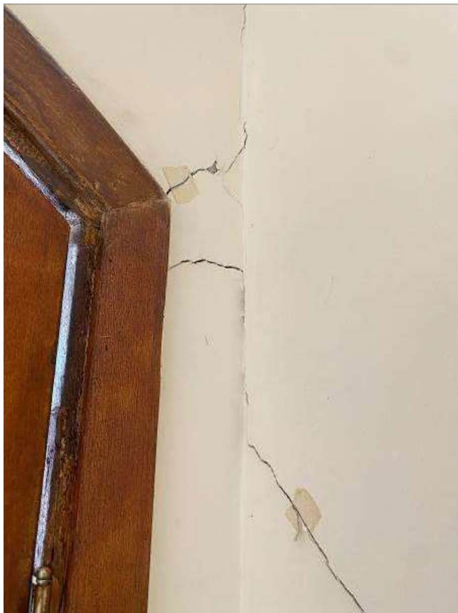
Foto 30: Vista parcial da parede próxima a porta de acesso à Sala. Em destaque, a existência de rachaduras no local.
