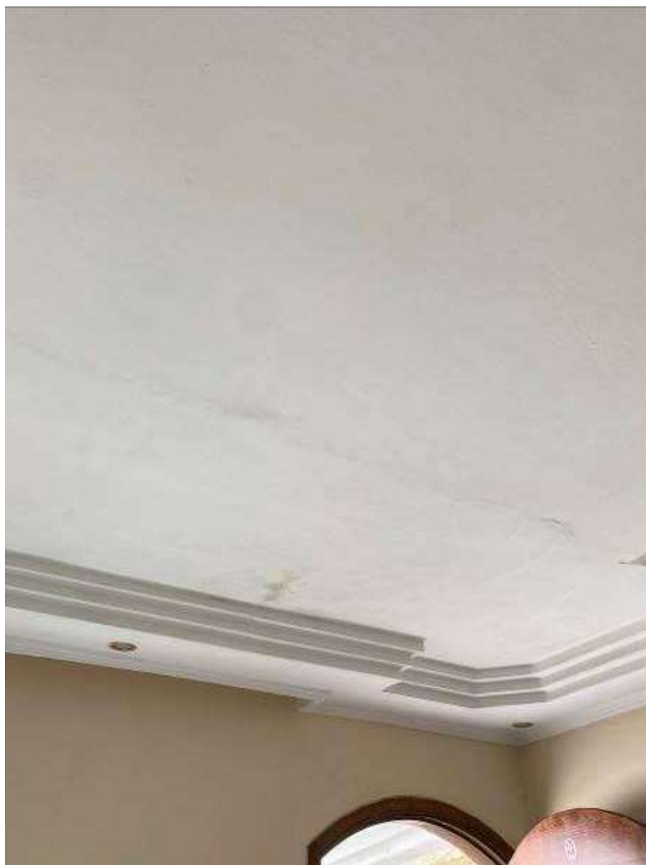
Foto 34: Vista parcial do teto da Sala. Nota-se a existência de manchas de umidade, fissuras e deslocamento da pintura.
