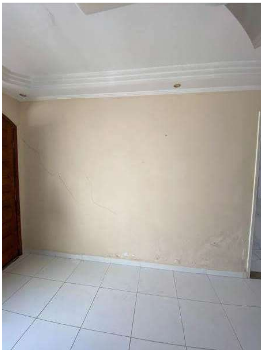
Foto 27: Vista de outra parede da Sala. Nota-se a existência de manchas de umidade, deslocamento/empolamento da pintura e rachadura passante para o Dormitório 1.
